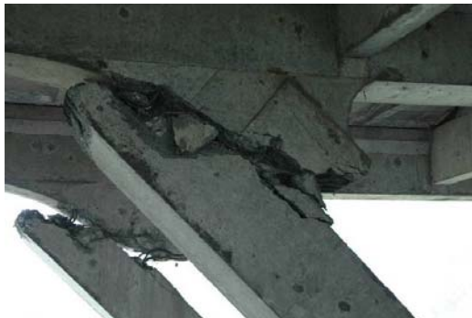
Fig. 11 Spandrel element fracture
